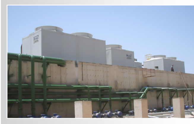
Rolling mill plants Прокатные цехи
