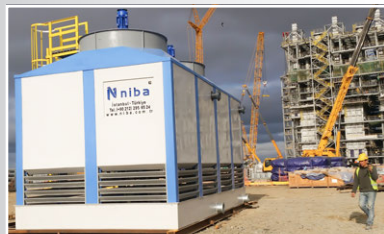
PP Plant - Turkmenbasi, Turkmenistan Завод ПП Hyundai - Туркменбашы, Туркменистан
